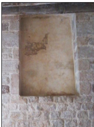
Intervenció a la finestra O del primer pis: sanejament, bisellat de les vores de lliscat original, reposició del lliscat perdut i entonat al fresc.
